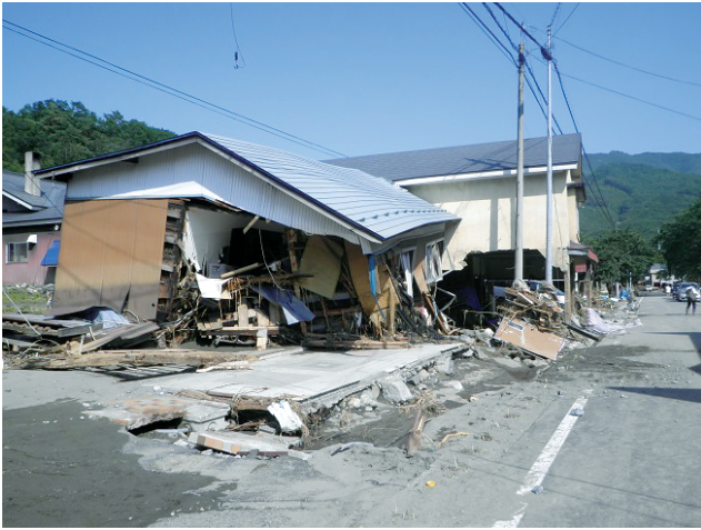
浸水により損壊した住家等 (岩泉町安家地区 仙台市消防局提供)
